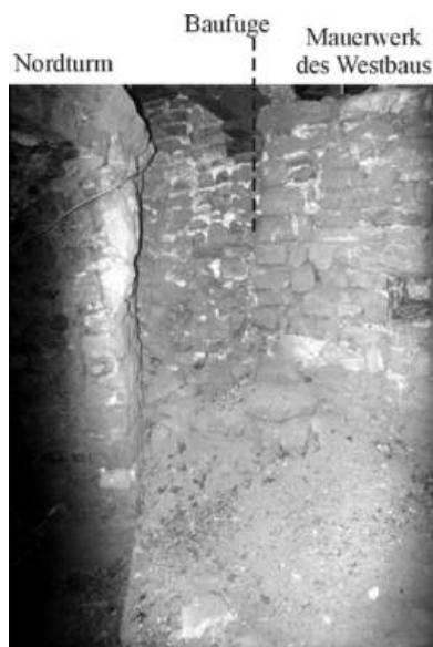
Baufuge beim Nordturm [Bild: Gerhard Roese]
